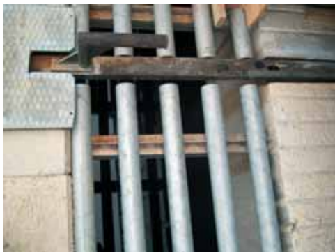
Jaucherinne mit «bovi-stop» für das Ende des Mistschiebers. Diese Roste sind befahrbar.
