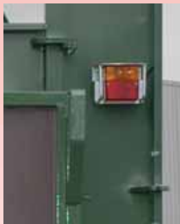
Feux de signalisation bichromatés et protégés, à bonne hauteur, selon le code de la route
